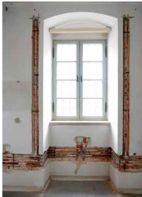
Verlegte Kupferrohre für die Bauteiltemperierung, Foto: Claudia Rühle
